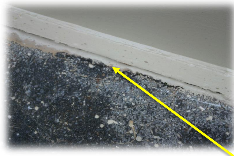
Области, подверженные коррозии
